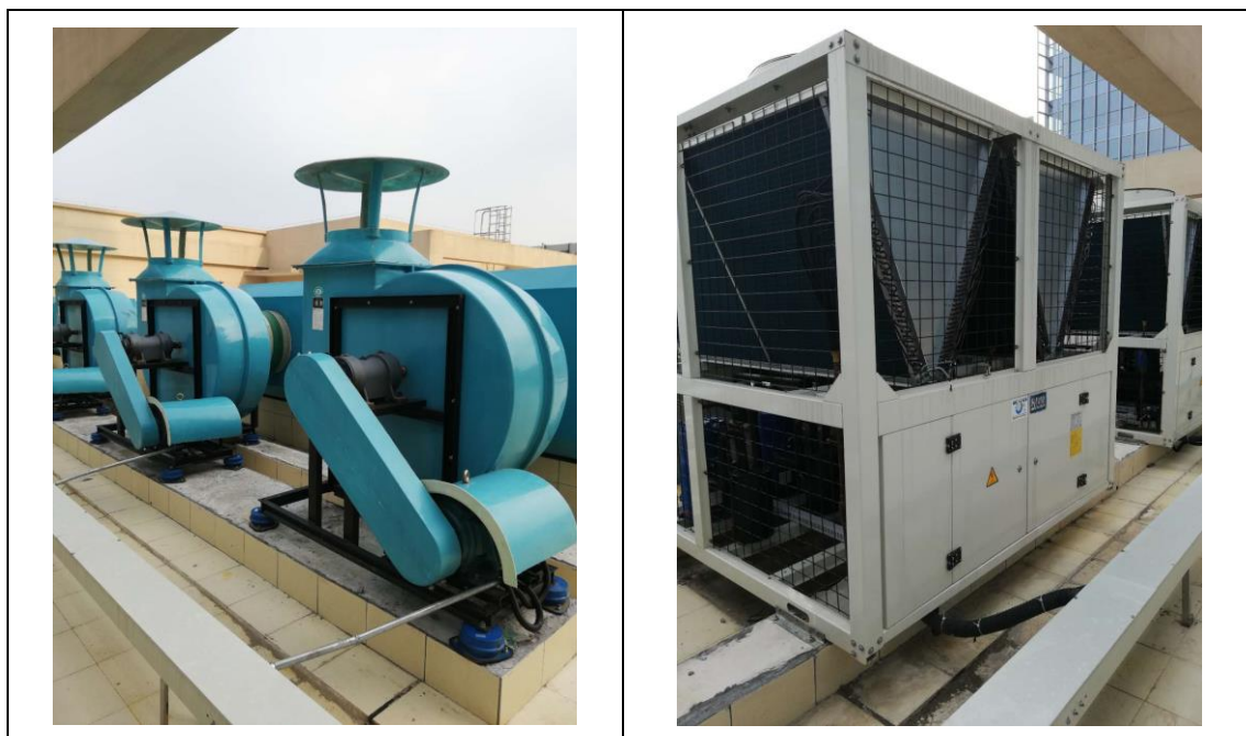
附图 6 废气治理设施图片
